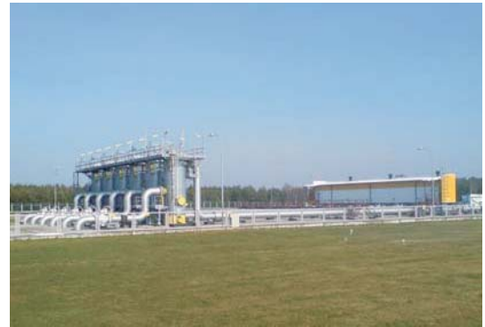
Pomiarownia gazu - tłocznia Kondratki
