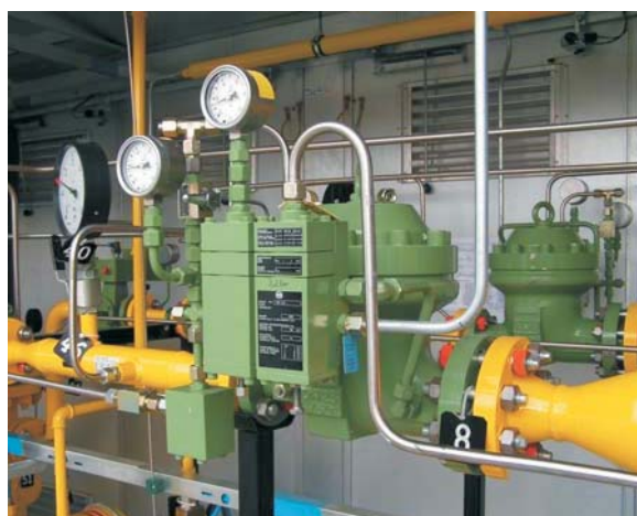
Armatura redukcyjno-zabezpieczająca RMG w stacji gazowej
