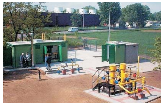
Stacja gazowa wysokiego ciśnienia - Jawor wyremontowana przez Gazomet
