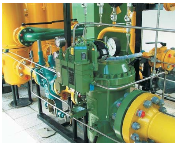
Armatura redukcyjno-zabezpieczająca RMG w stacji gazowej
