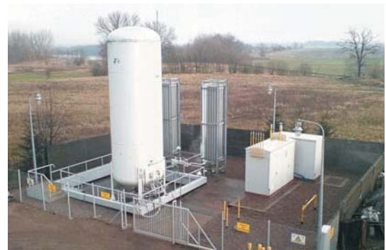
Stacja gazowa dla LNG.
