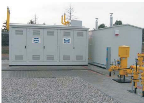
Stacja pomiarowa gazu w Międzybórz
