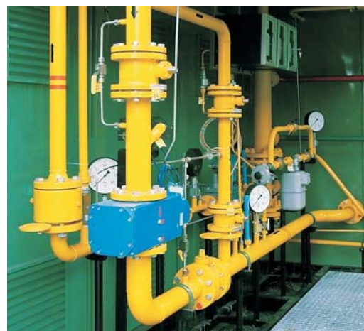
Stacja gazowa wysokiego ciśnienia w obudowie kontenerowej
